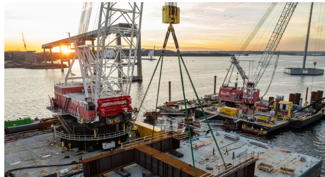
▲ Preparación de la grúa Weeks 533 para levantar el bastidor de carga y colocarlo sobre los pilotes de prueba.
